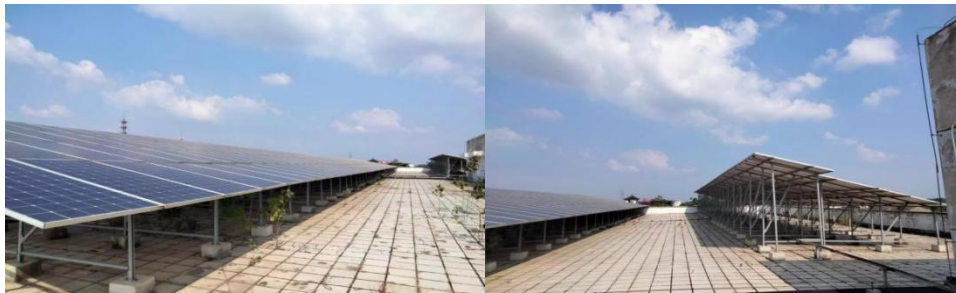
屋顶 太阳 能板
